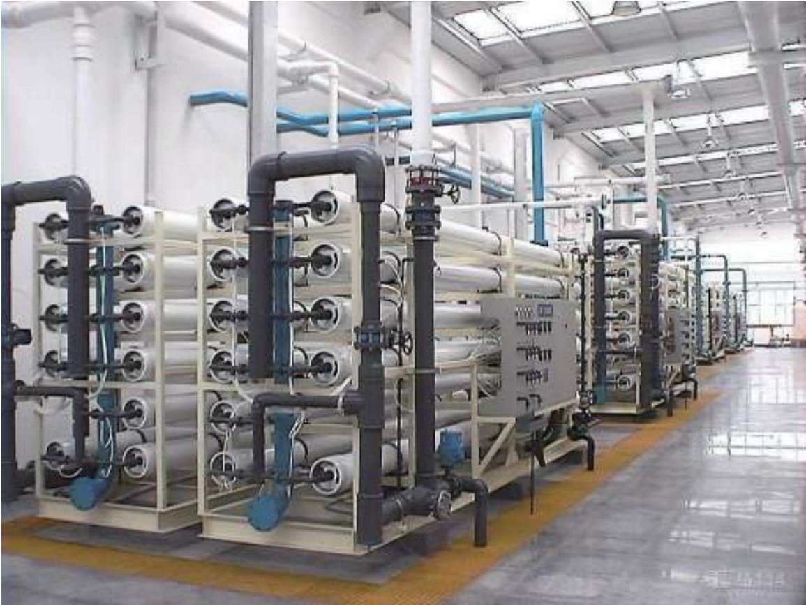
大型海水淡化设备
